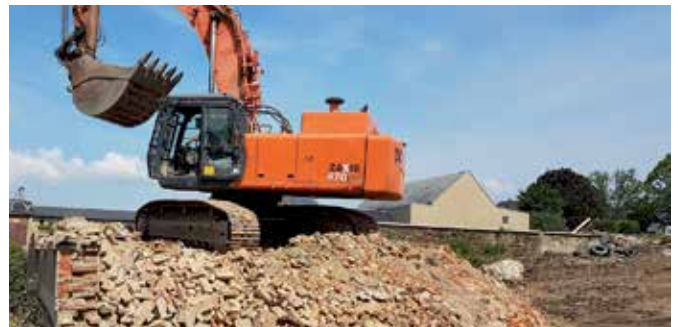
Abbruch Gebäude Lengenfelder Straße 13 im Ortsteil Mylau. Auf diesem Grundstück beabsichtigt der Eigentümer eine Wiederbebauung mit einem Einfamilienhaus.
