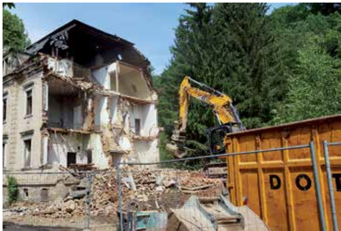
Das Gebäude Karl-Marx-Ring 14 im Ortsteil Mylau war einsturzgefährdet. Die Stadt Reichenbach beauftragte den Abbruch als Ersatzvornahme. Gleichzeitig wird das Gebäude Karl-Marx-Ring 16 abgerissen.
