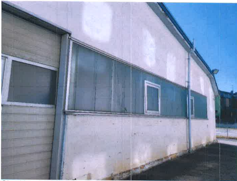
Glas-Lichtband (tlw. beschädigt), links im Bild das Rolltor (nach 1990 eingebaut)
