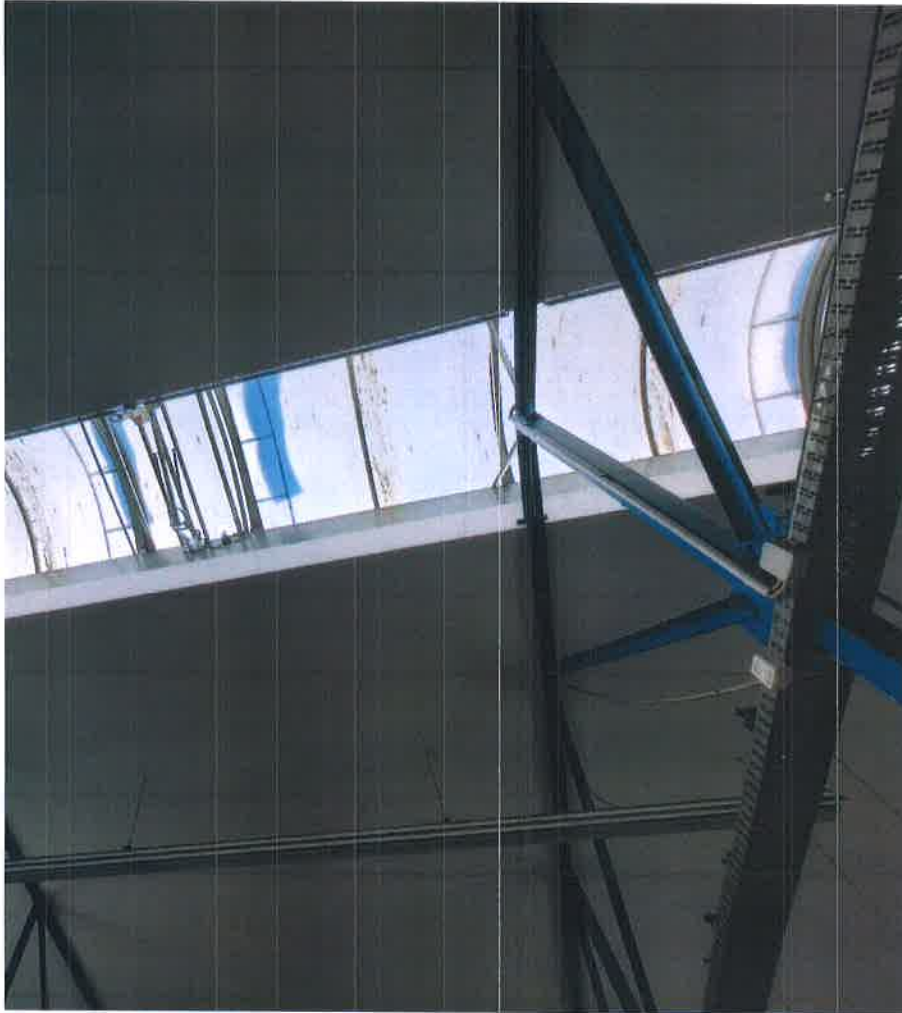
Blick auf das Lichtkuppelband (elektrisch bedienbar/Lüftung)
