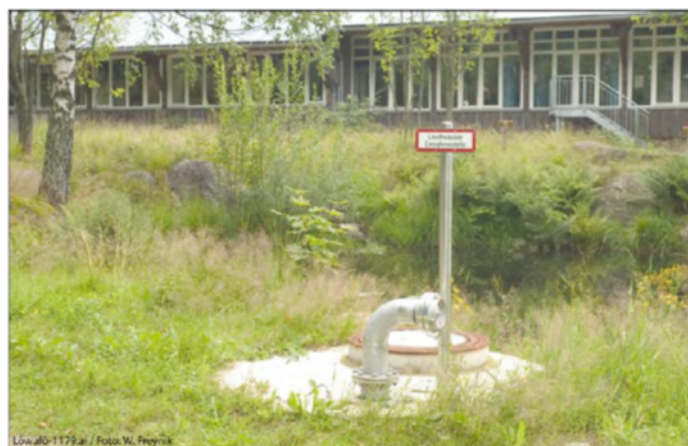
Ansicht einer Löschwasserentnahmestelle eines Löschteichs
