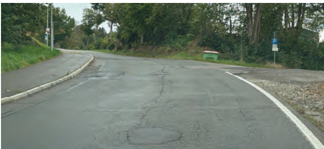
Straßenzustand vor der Sanierung
