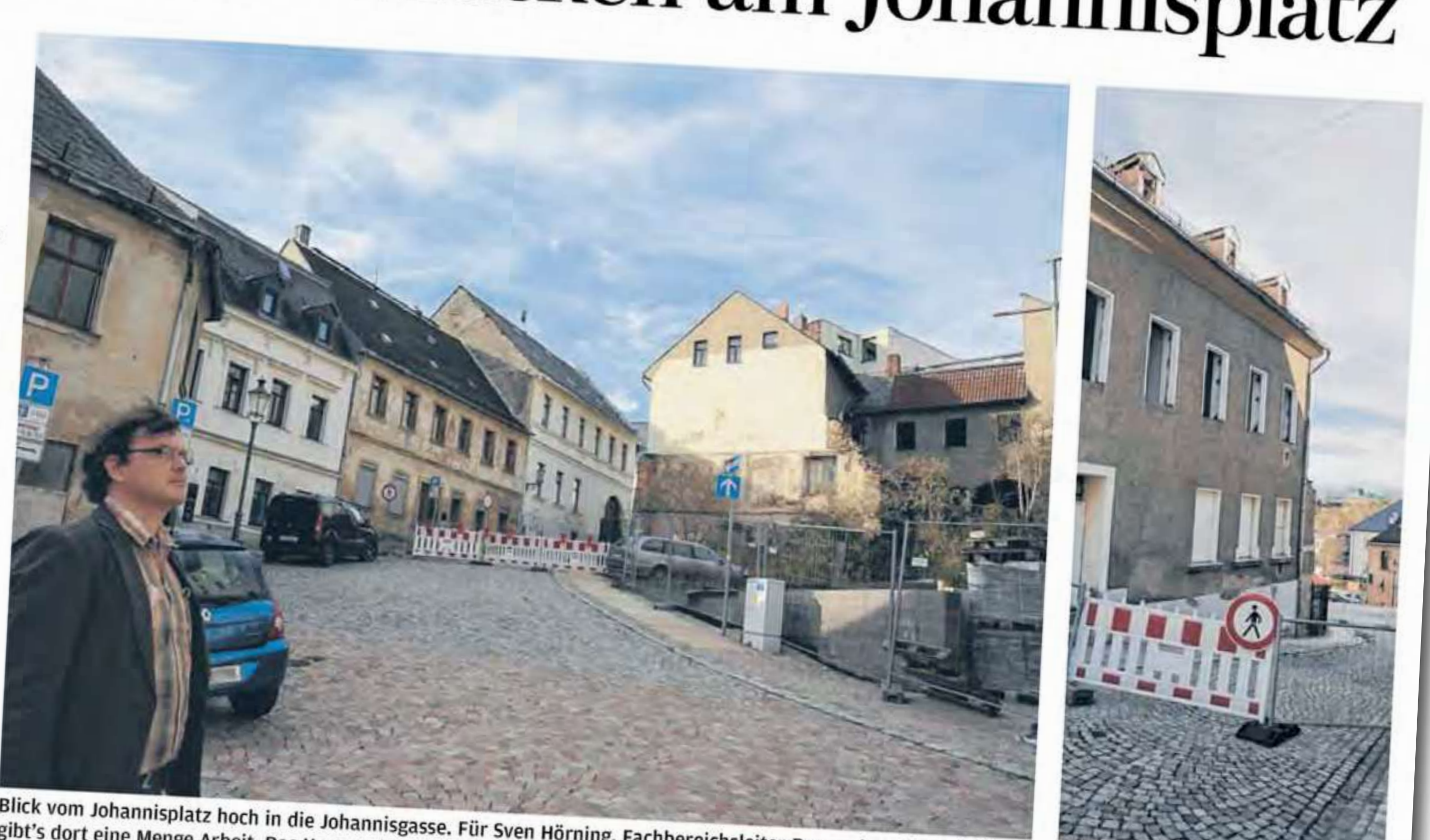
Blick vom Johannisplatz hoch in die Johannisgasse. Für Sven Hörning, Fachbereichsleiter Bau und Stadtentwicklung, hat Auswirkungen auf die Nachbarbebauung. Auch das Haus links im Bild ist ein Abrisskandidat.
