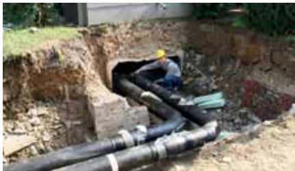
Der Meister der Gas- und Wärmeversorgung, Lucas Halsema, bei Montagearbeiten der Endmanschette an der Fernwärmetrasse.
