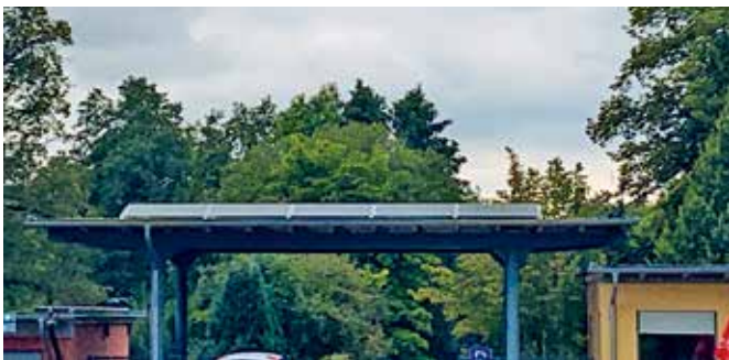
Die Photovoltaikanlage erzeugte bereits in dieser Badesaison Strom für die Pumpen im Freibad und sorgte für azurblaues, sauberes Wasser.
